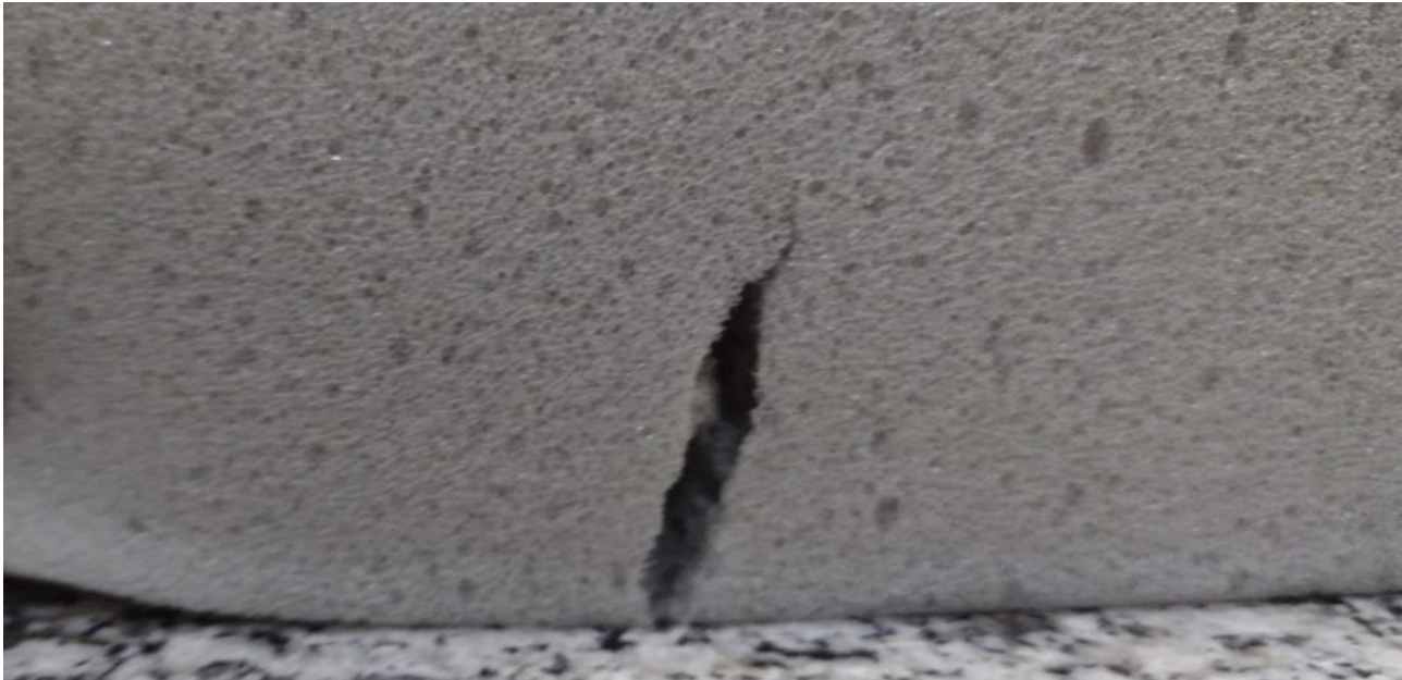
FOTOS 6 E 7 – FALHAS ESTRUTURAIS NO BLOCO DE ESPUMA
